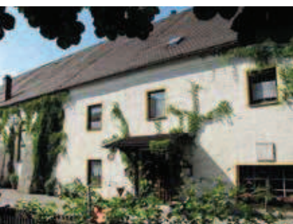
Blick auf das Gasthaus in seinem heutigen Zustand. Links des Eingangsbereiches schließt sich das ehem. Sudhaus an.
